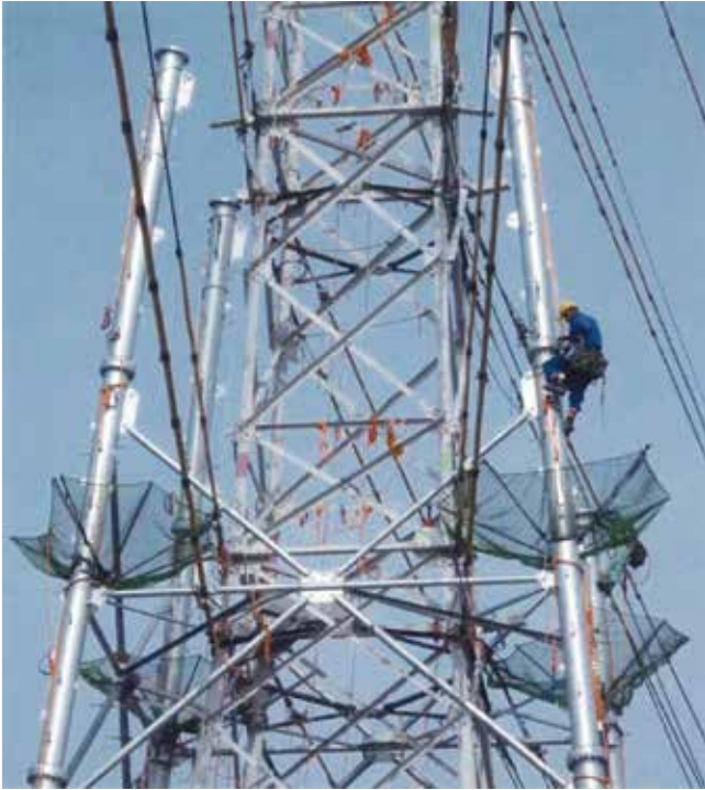
鋼管鉄塔における使用状況
