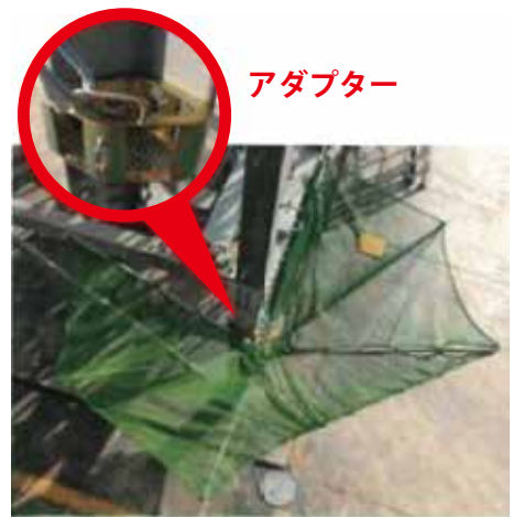
山形鋼鉄塔における取付状態
